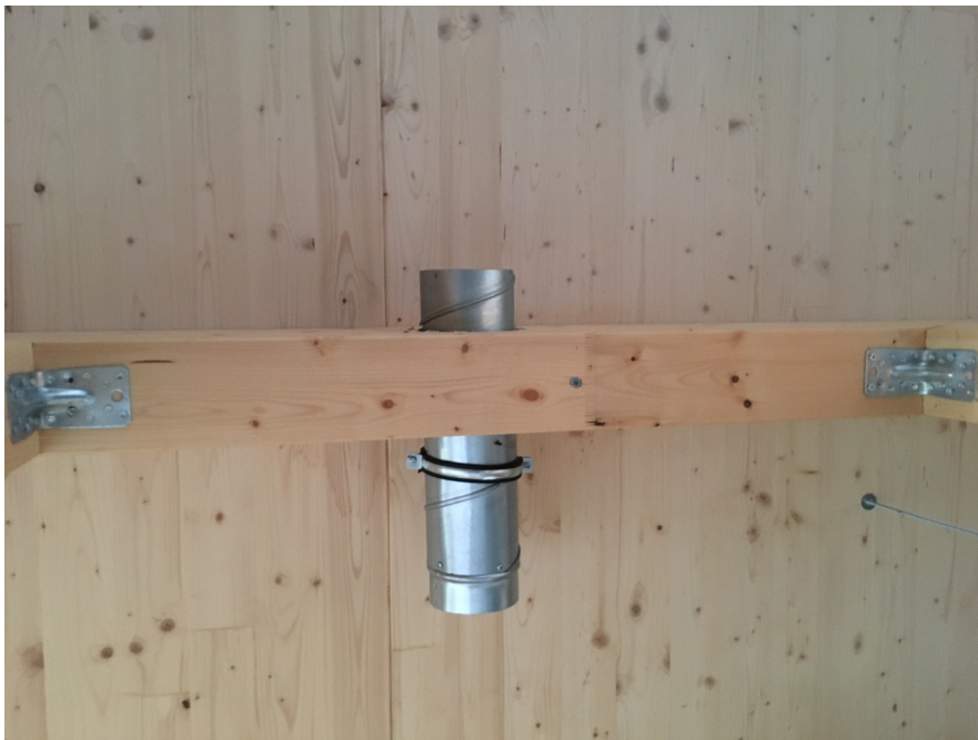
Photo 6 : vernis repris sur plafond CLT au niveau de la gaine: reprise invisible
